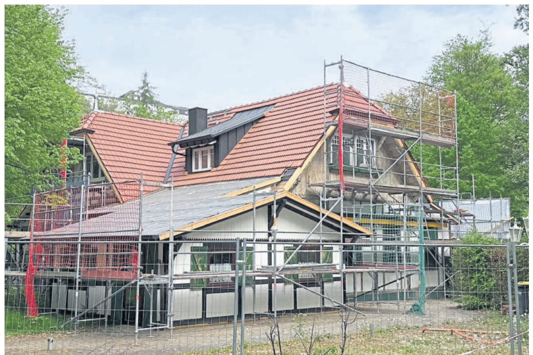
Das Golfhaus mit dem neuen Hauptdach vor dem Brand am 9. Mai.
